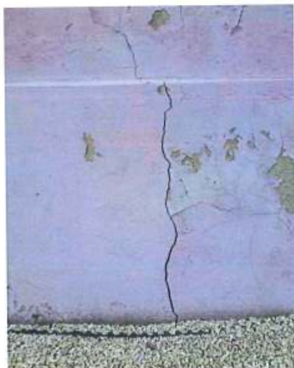
Fot. 5 – Pęknięcie muru kapliczki od strony północnej.
