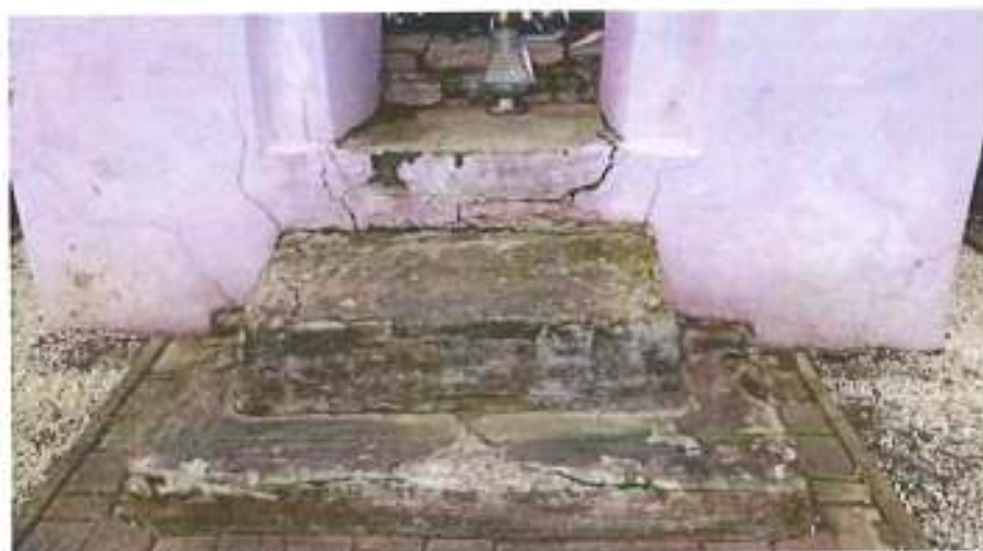
Fot. 3 – Zużyte stopnie kamienne kapliczki, latane betonem.
