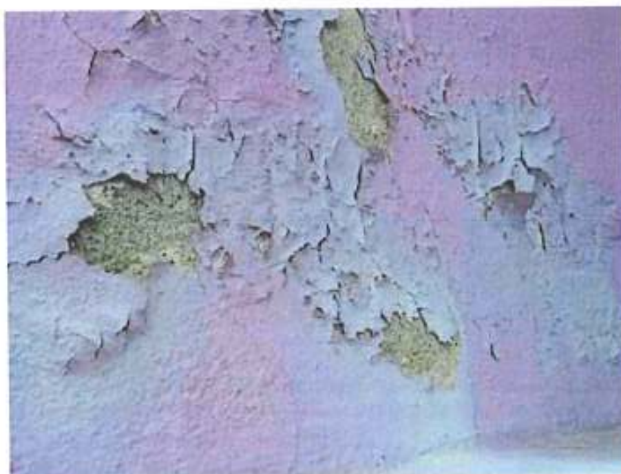
Fot. 4 – Zawilgocone, zmurszałe i odpadające tynki na elewacjach kapliczki
